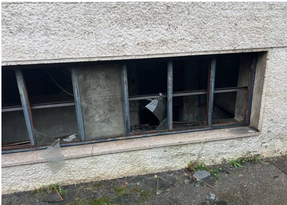
Le finestrelle dell'interrato da cui si è sviluppato l'incendio del 5 dicembre, in via dei Mille
