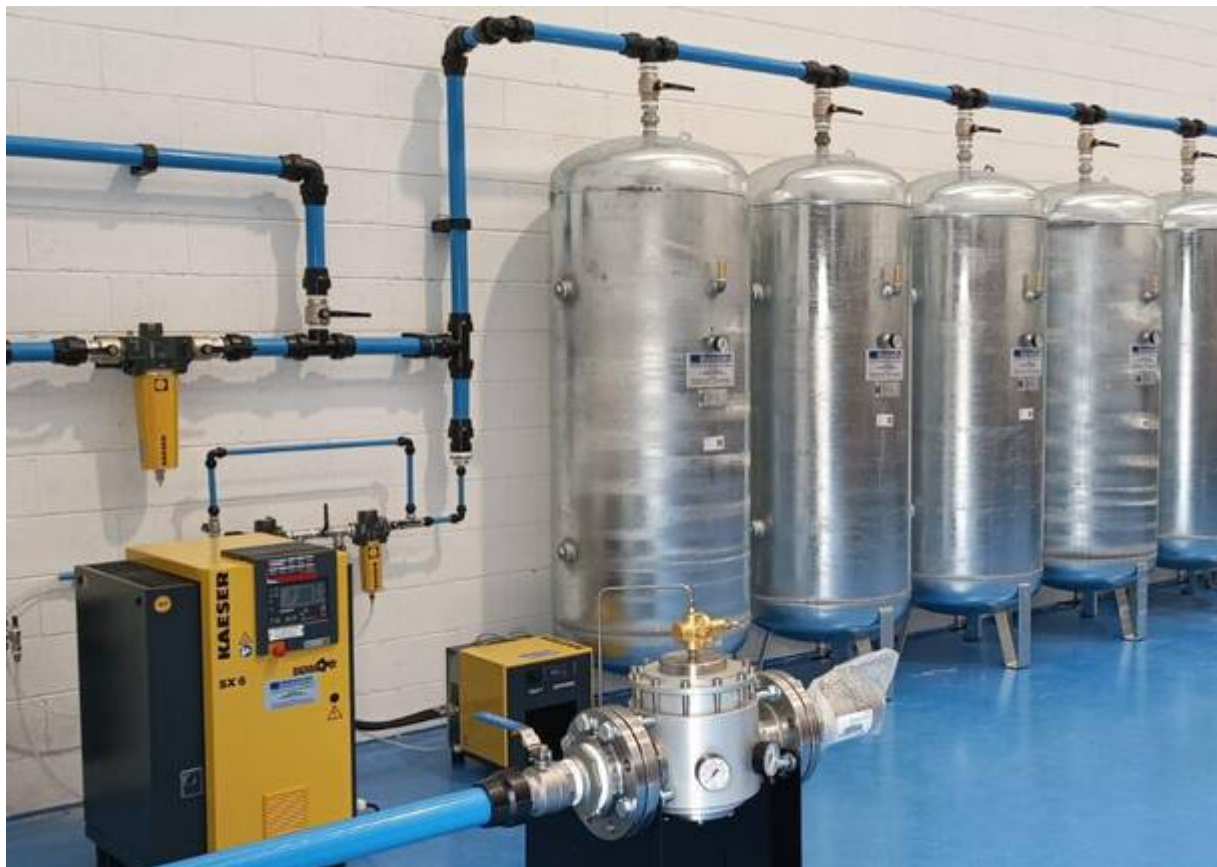
Impianto aria compressa
