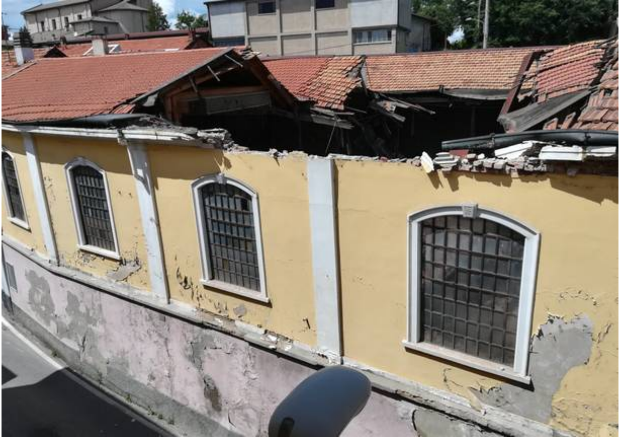
L'edificio di via Milano al momento del crollo del 2026
